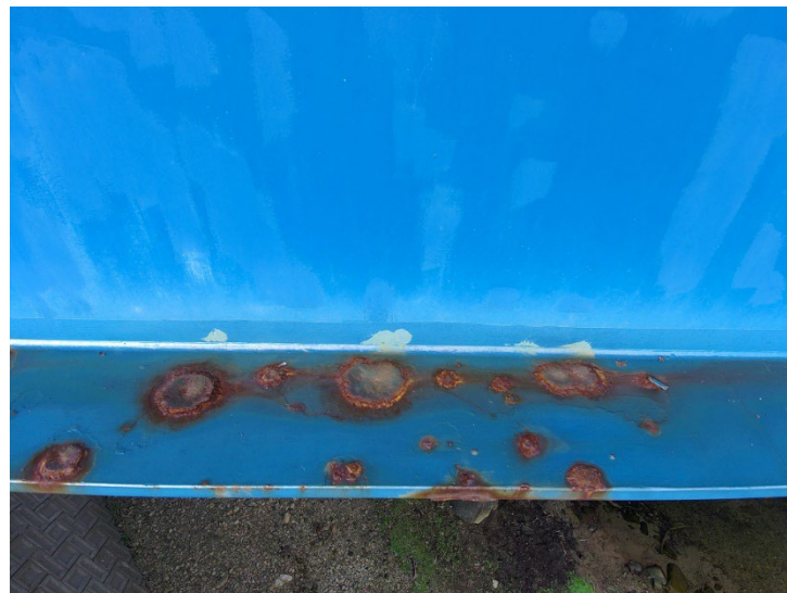
写真-3 主桁(腐食)
