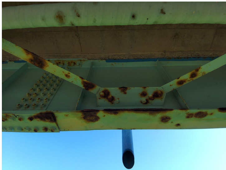
写真-3 主桁(腐食)
