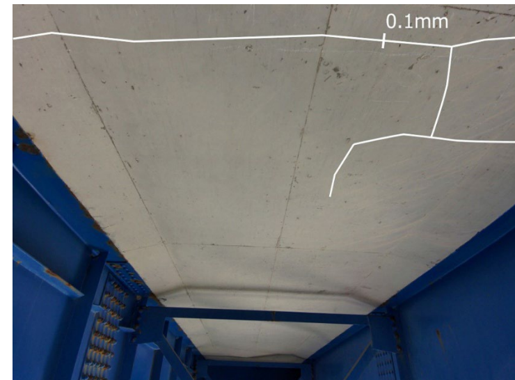
写真-4 床版(ひびわれ W=0.1mm)
