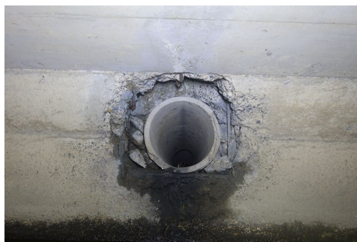
写真-4 側壁(剥離・鉄筋露出)
