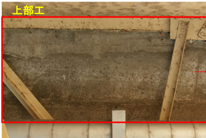
写真-3 損傷確認(床版ひびわれ)
