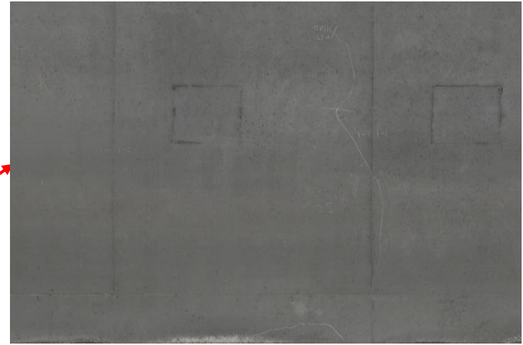
写真-2 画像展開図(ひび割れ)
