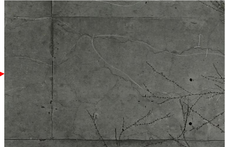
写真-2 画像展開図(ひび割れ)
