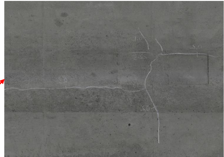
写真-2 画像展開図(ひび割れ)
