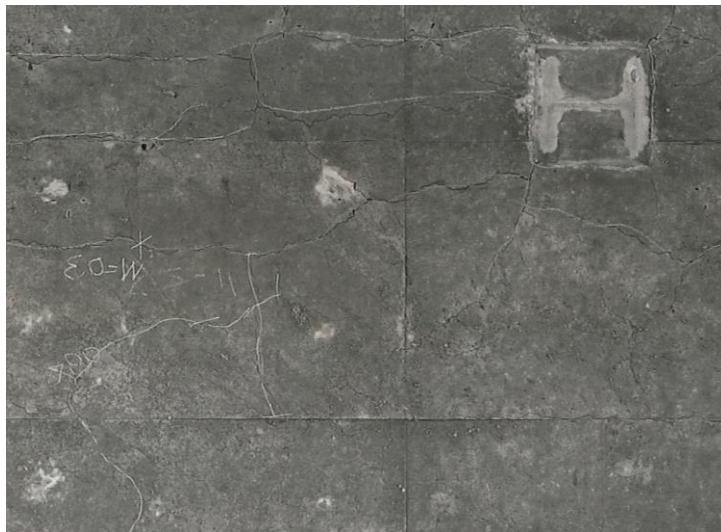
写真-3 画像展開図(ひび割れ)
