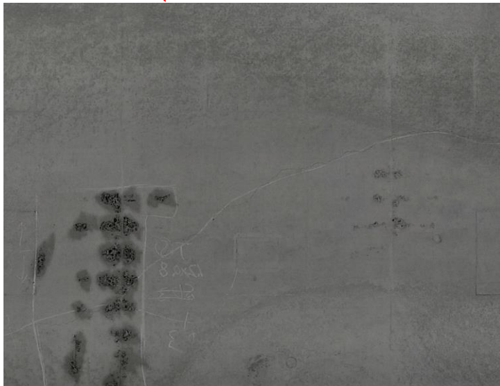
写真-3 画像展開図(ひび割れ, うき)
