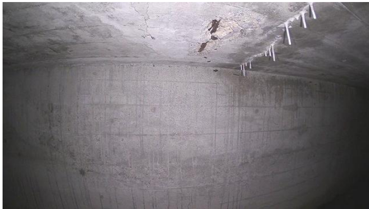
写真-3 主桁(剥離・鉄筋露出 :d)
