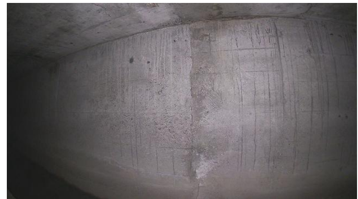
写真-4 橋台(漏水・遊離石灰 :d)
