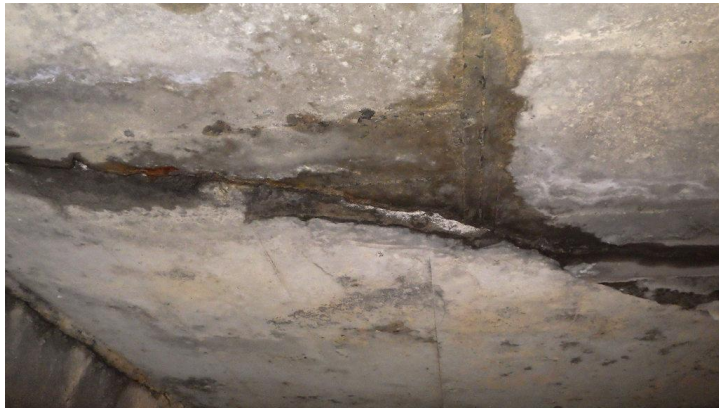
写真-3 主桁(ひびわれ 中小:c)
