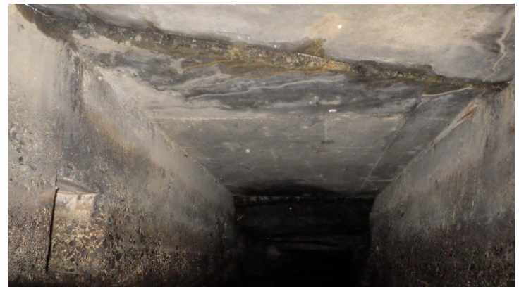
写真-4 主桁(漏水・遊離石灰 :d)
