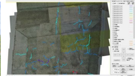
ひびわれ検出例(出典：ひび検性能カタログ)
