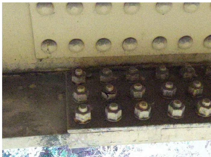
写真-3 主桁:腐食
