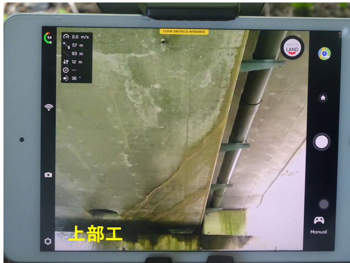
写真-3 損傷確認(上部工) 操作画面
