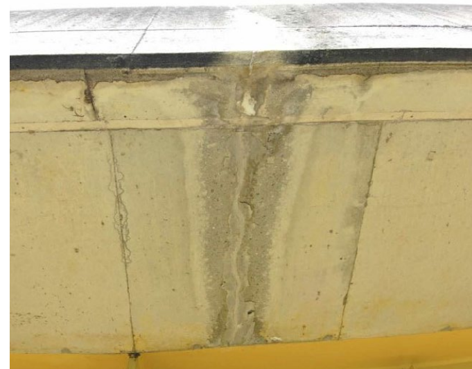
写真-4 床版:漏水・遊離石灰
