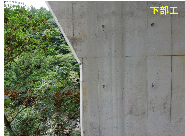
写真-4 損傷確認(下部工)
