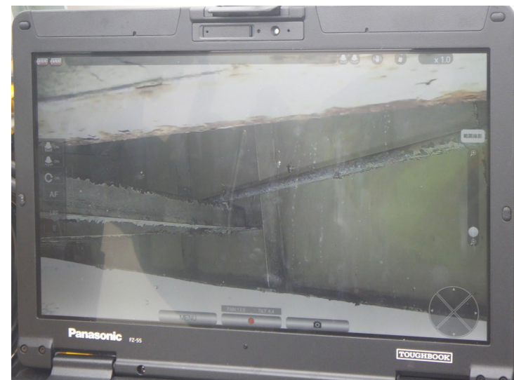
写真-4 損傷確認[腐食]
