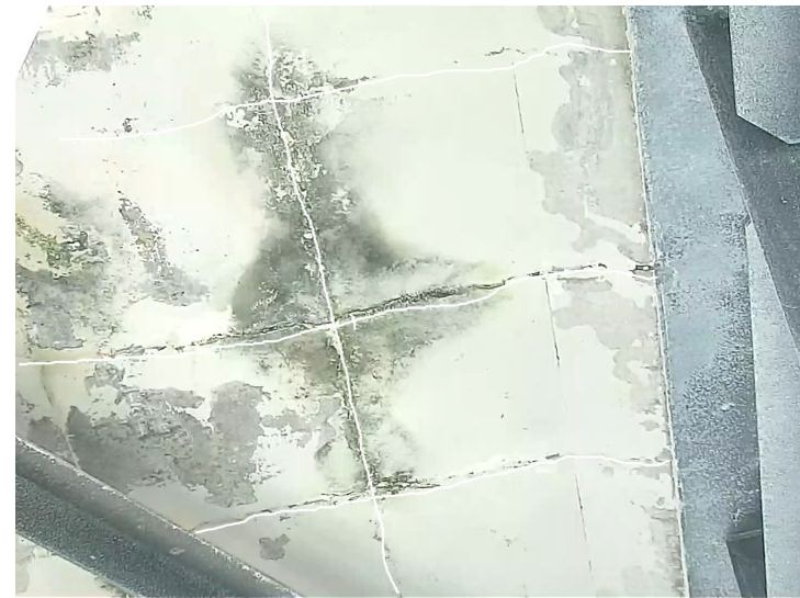
写真-4 床版(床版ひびわれ:d)
