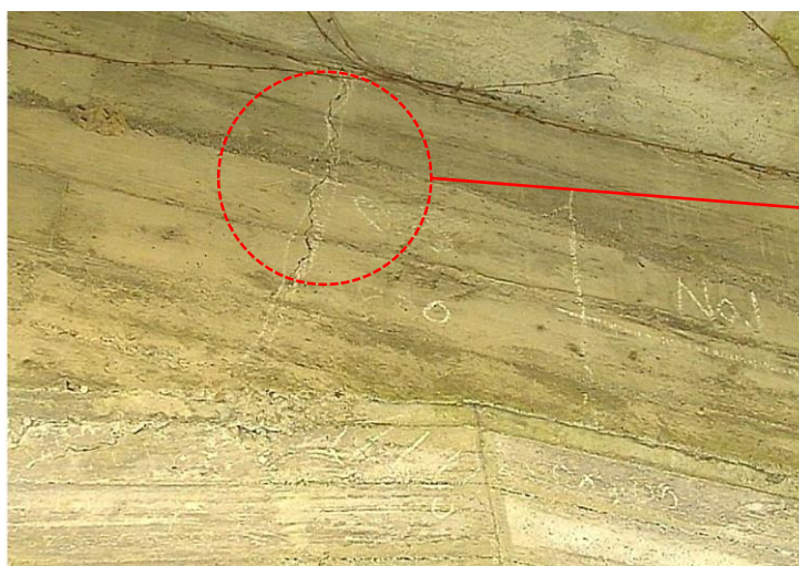
写真-3 損傷確認 (ひびわれ)
