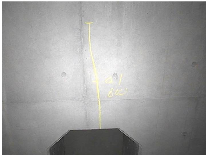
写真-3 損傷確認 (ひびわれ)
