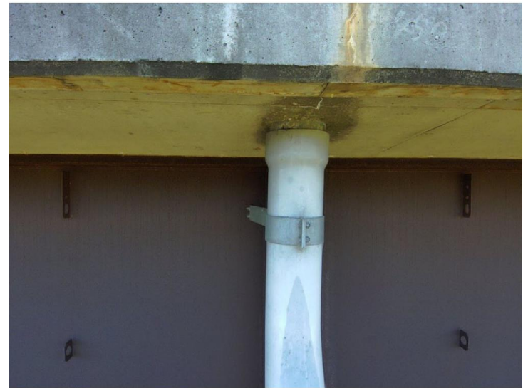
写真-4 排水管(漏水・滞水:e)
