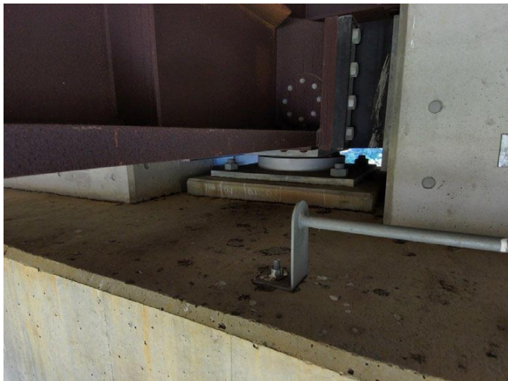
写真-3 沓座モルタル(ひびわれ)
