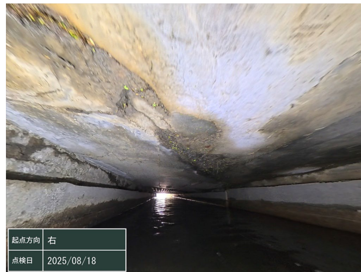
写真-4 頂版(その他(伝い水汚れ):e)
