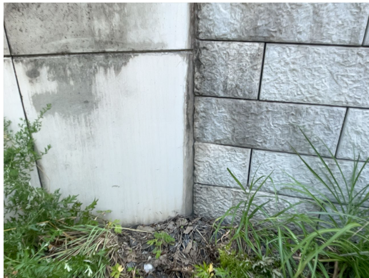
写真-3 損傷確認[漏水]
