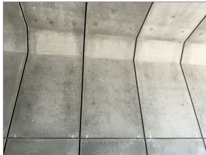
写真-2 損傷確認[変形・欠損]
