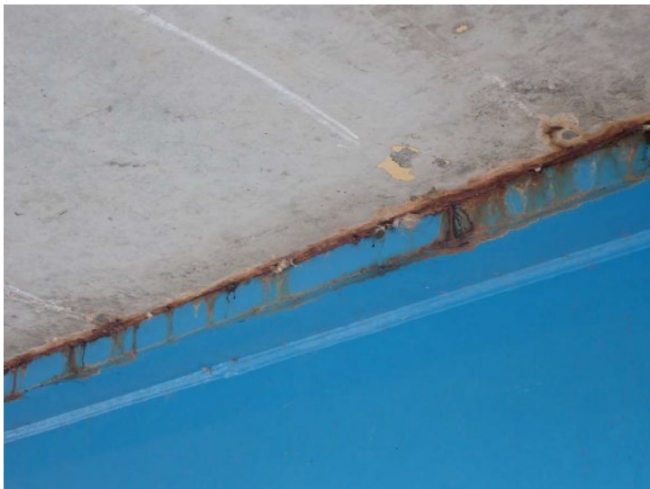
写真-3 主桁(腐食:b)
