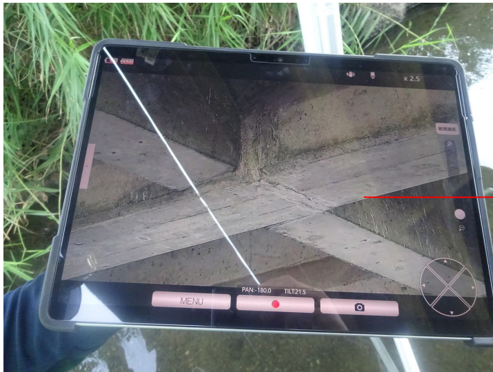
写真-3 損傷確認[ひびわれ]
