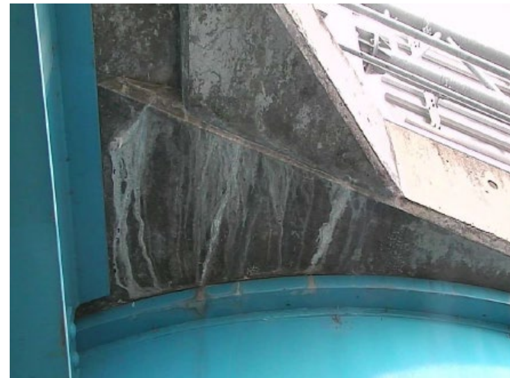
写真-4 床版(漏水・遊離石灰:d)
