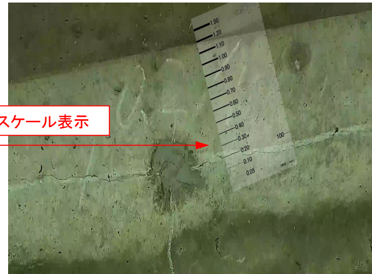
写真-4 損傷部拡大写真
