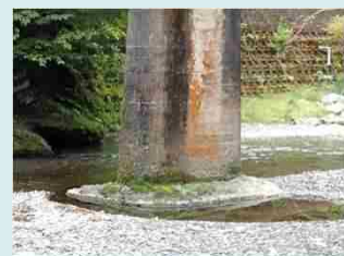
洗堀された橋脚
