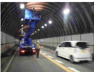
トンネル点検車 (国道9号新和田山トンネル:兵庫県朝来市)
