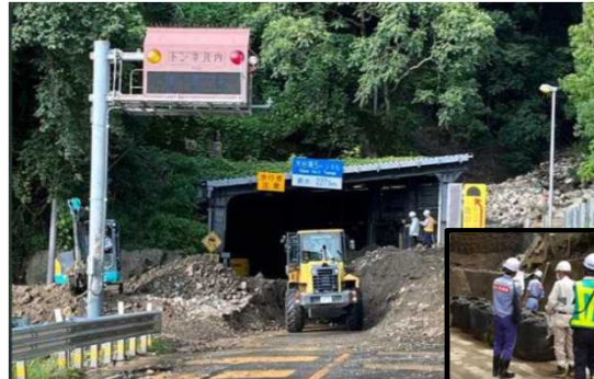
国道8号 福井県南越前町：土砂流出
