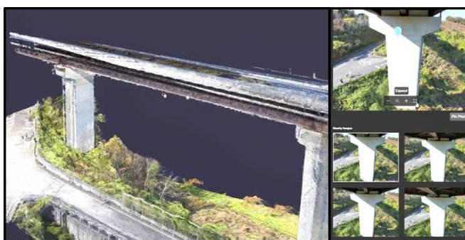
点検データの3Dモデルビューワー 国道24号市脇高架橋（和歌山県橋本市）
