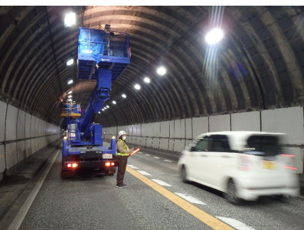
トンネル点検車 (国道9号新和田山トンネル:兵庫県朝来市)
