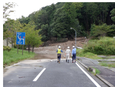
R161 大津市 近江神宮ランプ付近 自然斜面崩落
