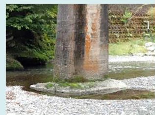
洗堀された橋脚
