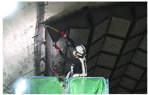
トンネル打診点検 (国道158号 越坂トンネル：福井県永平寺町) (福井河川国道事務所提供)
