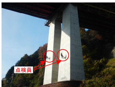
ロープアクセスによる点検 (国道25号中畑橋:奈良県奈良市)
