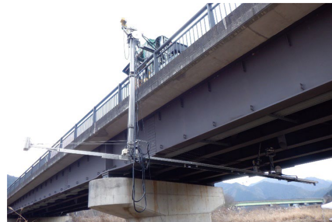
橋梁点検支援ロボット(視る診るスタンダード)
