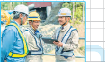
メールをチェック後、1日の工事内容とスケジュールを担当者に交えて確認します。
