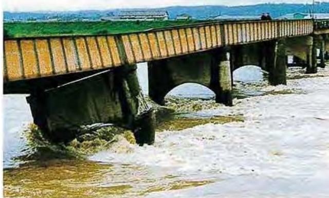
昭和45年6月 前線による出水の状況(上荘橋付近)
