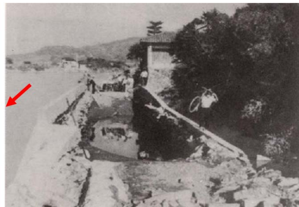
県道海南九度山線： 麻生津(おうづ)～竜門間の被害状況 (昭和28年台風13号)
