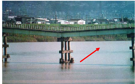
川底がえぐり取られて陥没した南海橋 (平成 2 年台風 19 号)
