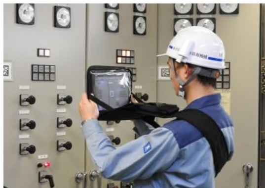
②「排水機場運転支援システム」
