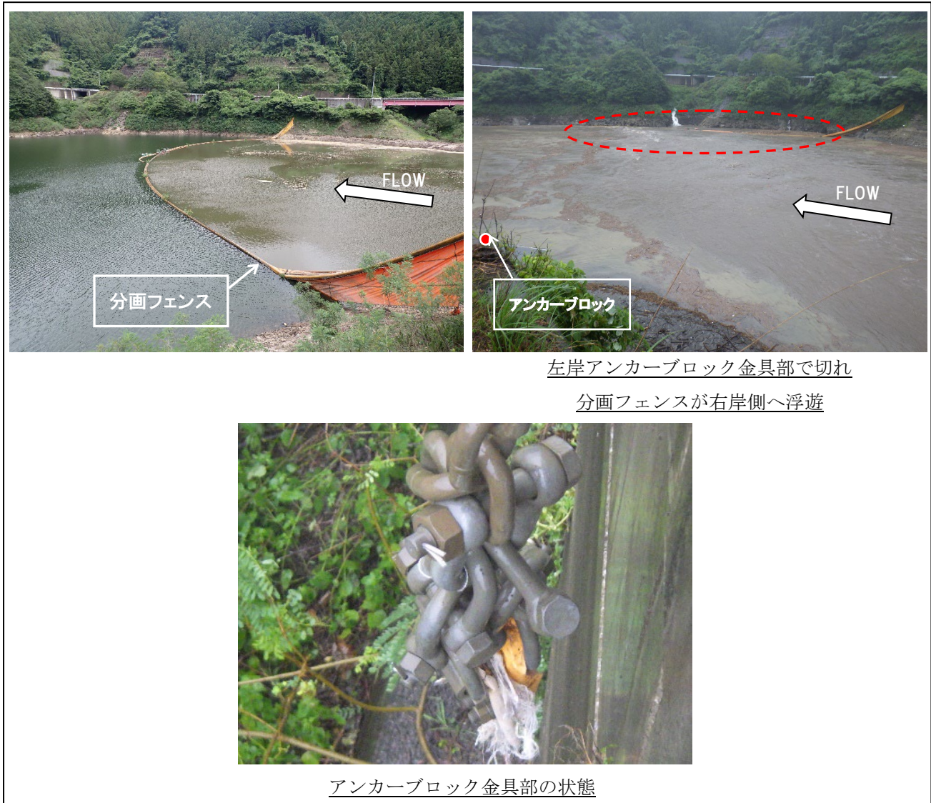
図 5.6.2-3 分画フェンス破損状況
