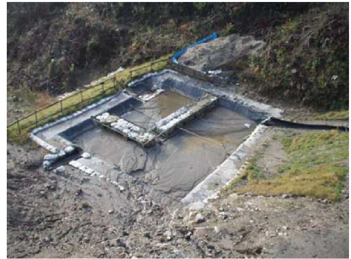
写真 3.2-4 沈砂池の設置状況
