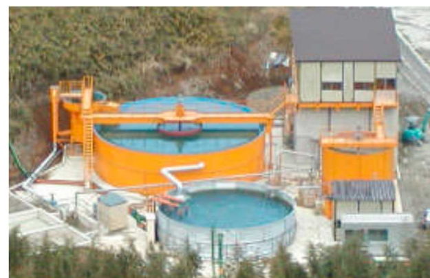
濁水処理施設 (他ダム事例)
