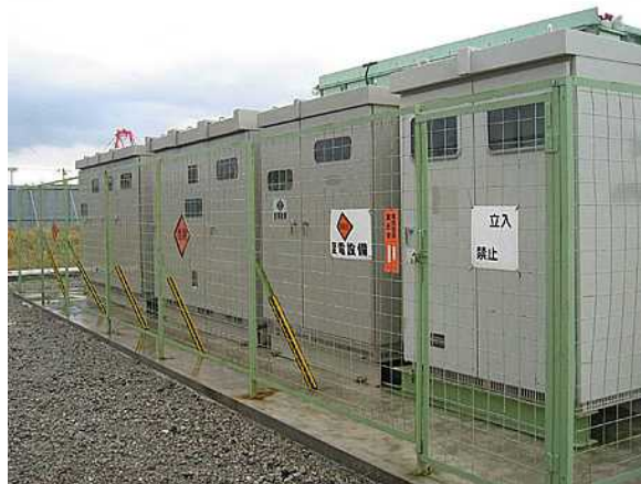
受電設備写真（他ダム事例）
