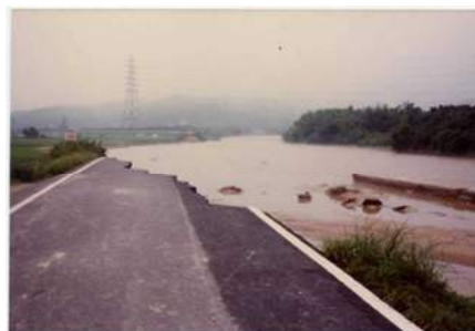
写真 2.2-5 大津市上田上の道路被害
