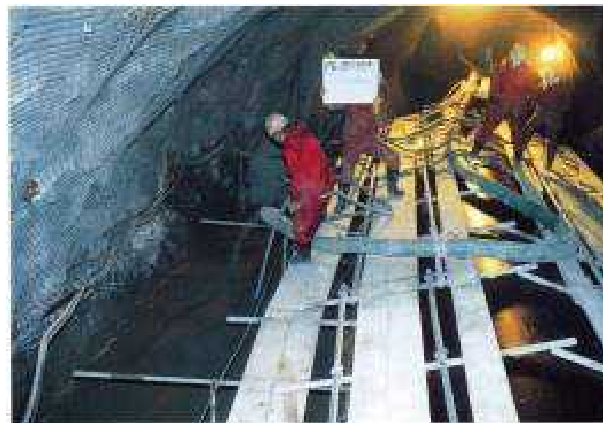
転流工閉塞状況（他ダム事例）
