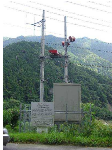
警報設備（他ダム事例）
