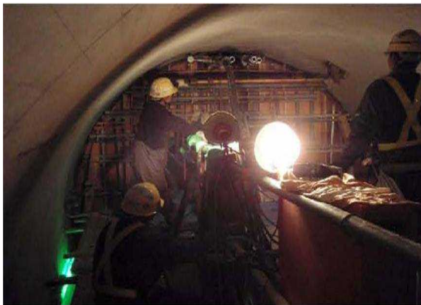
転流工閉塞状況（他ダム事例）
