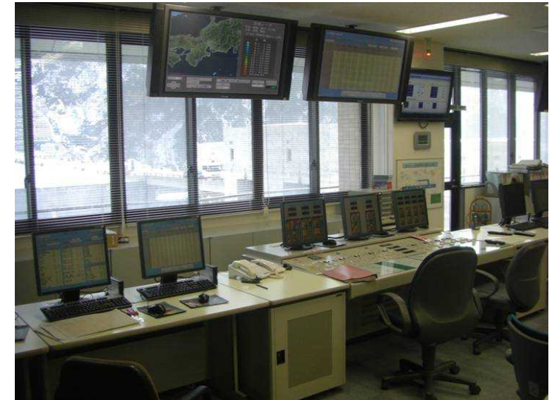
放流制御設備（他ダム事例）
