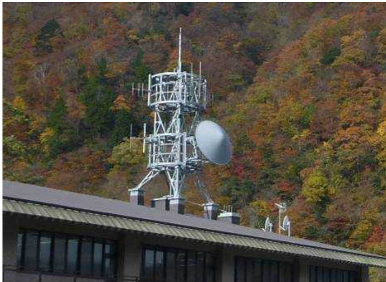
通信設備（他ダム事例）
