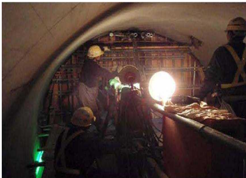
転流工閉塞状況（他ダム事例）
