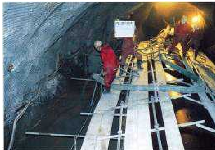
転流工閉塞状況（他ダム事例）
