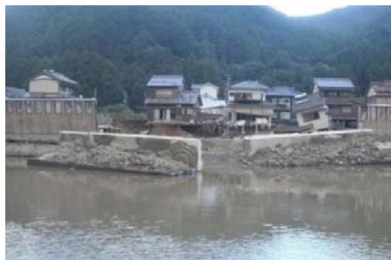
紀宝町（高岡地区）輪中堤の被災状況
