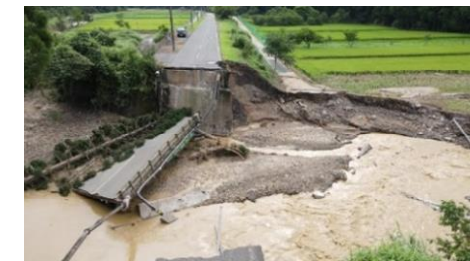
令和4年8月豪雨(福井県丹生郡越前町)
