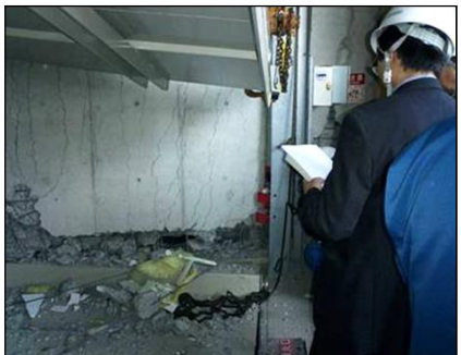
建物危険度判定
