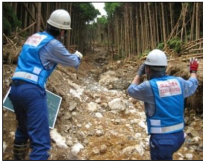
土砂災害調査
