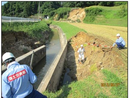
被災状況調査
