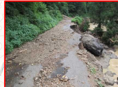
No.60・62 路肩欠損
