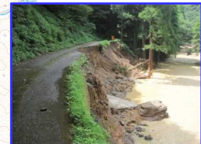
No.54 路肩欠損
