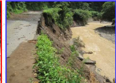
No.56 路肩欠損
