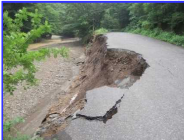
No.75 路肩欠損
