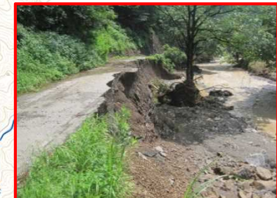
No.49 路肩欠損
