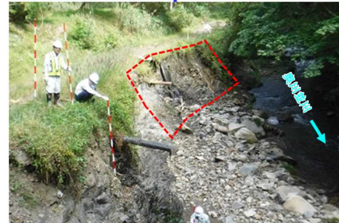
第12号 路肩崩落
