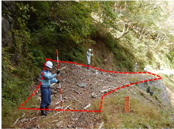
第7号 土砂流出・路肩崩落
