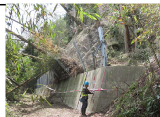
3/16 宮城県東松島市矢本 地震により落石が発生し、落石防護柵が被災
