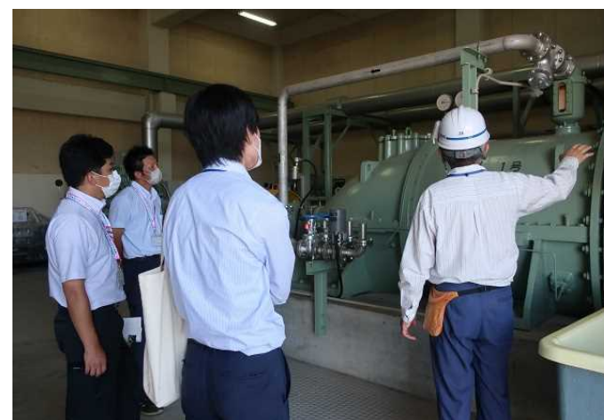
令和4年7月29日 赤野井排水機場
