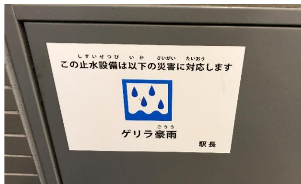
写真6. 大阪メトロ本町駅の止水パネル (撮影：日本気象協会)
