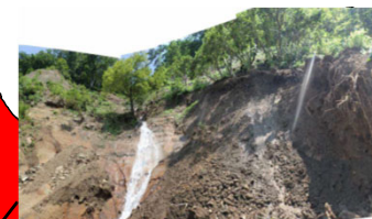
7/5 北海道福島町 山腹崩壊により道道に土砂流出
