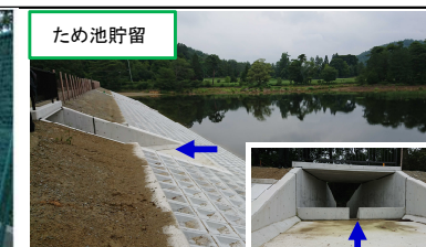
ため池貯留 平井の池(三田市)等 ため池貯留4池・9.9万 m^3 (R3.3実績)
