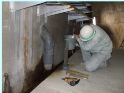
継目排水孔からの漏水量の計測
