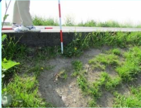
破損状況(H25点検時)
