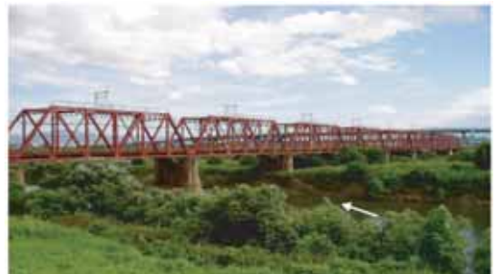
写真 3.6-2 河道内樹木の繁茂状況 (木津川)
