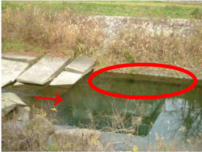
護岸ブロック基礎が露出
