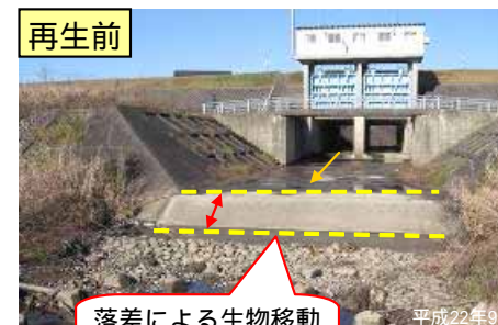
落差による生物移動の連続性の阻害
