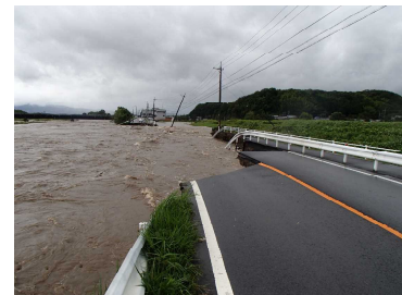
国道422号被災状況
