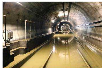
（写真下） 浸水した地下鉄 東西線のトンネル
