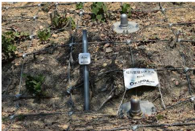
■写真-3 OKIPPA104の設置状況
