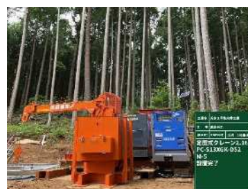
写真-7 定置式クレーン
