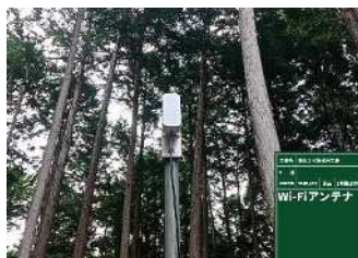
写真-18 Wi-Fiアンテナ
