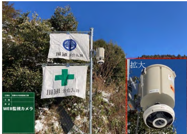
写真-7 WEB監視カメラ設置
