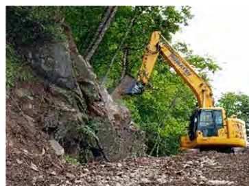
施工前の破碎状況
