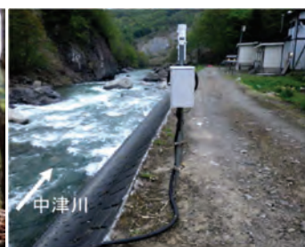
水位計(データ伝送部) 携帯回線で事務所等へ24時間配信 (10分間隔、電源はソーラーパネル)
