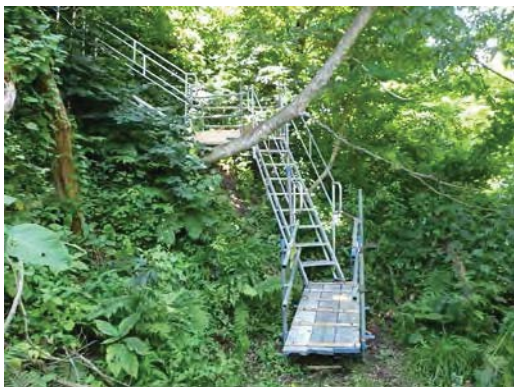
写真-8 昇降設備・避難訓練状況
