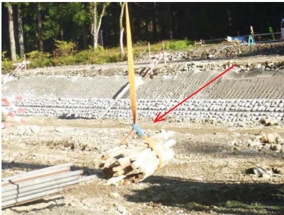
写真7 玉掛けが不安定である
