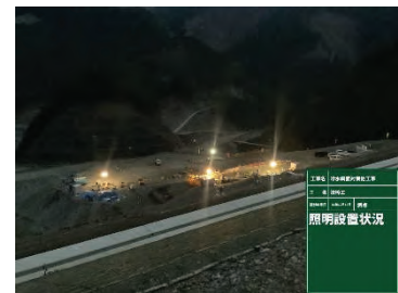
写真-8 照明設備
