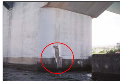
門柱コンクリートの剥離
