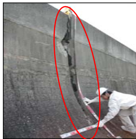
特殊堤の変状
