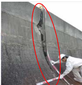
特殊堤の変状
