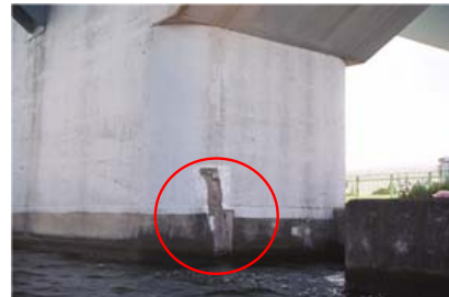
門柱コンクリートの剥離
