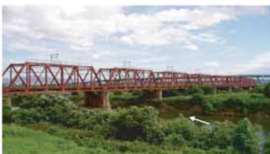
写真 3.6-2 河道内樹木の繁茂状況（木津川）
