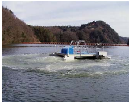
写真 4.2.5-3 循環曝気設備稼働状況
