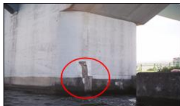
淀川大堰堰柱コンクリートの剥離
