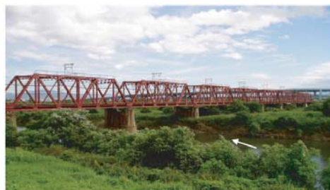
写真 3.6-2 河道内樹木の繁茂状況(木津川)
